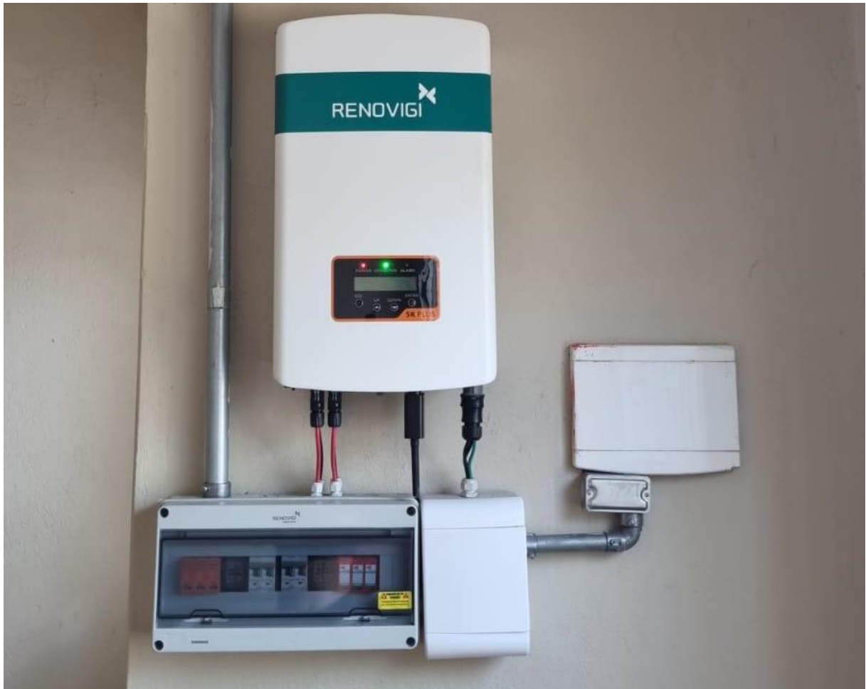
Figura 11 – Inversor RENOVIKI 5kW da instalação.
