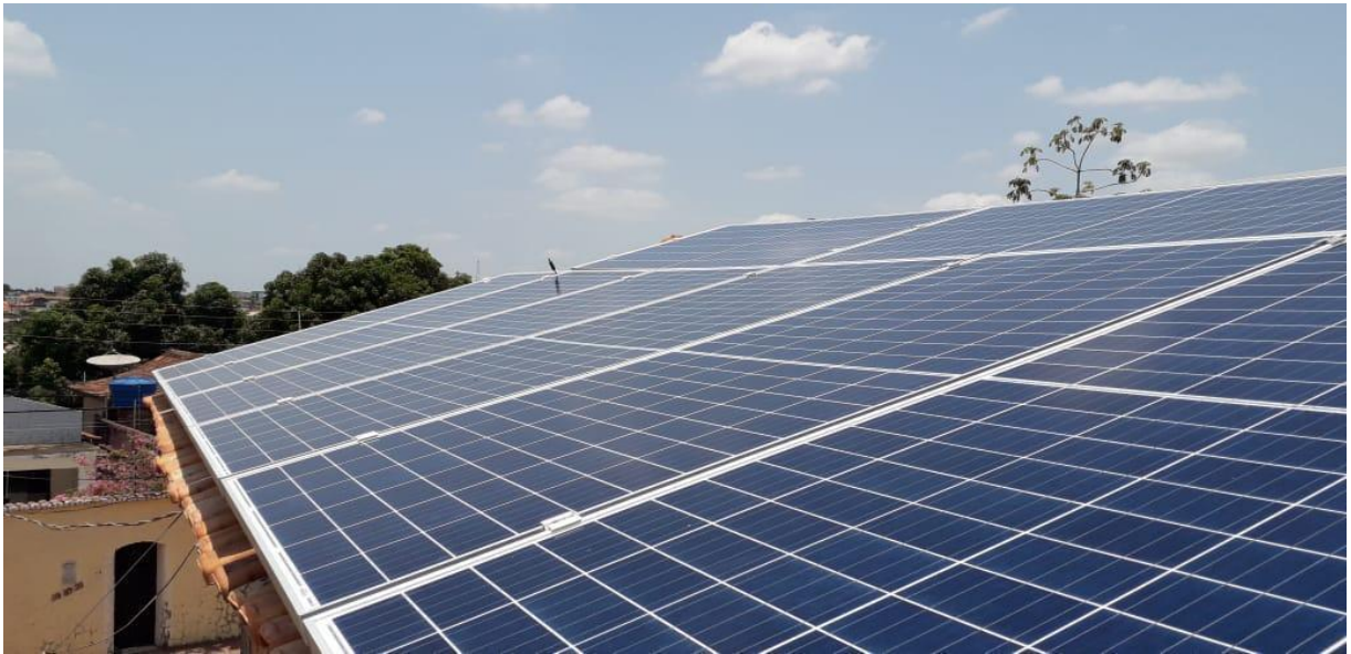
Figura 10 – Painéis solares da instalação.
